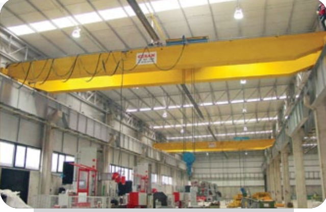
Fabrika Uygulaması: Düz Tip Çok Yakıclı Sistem – Genel Isıtma
