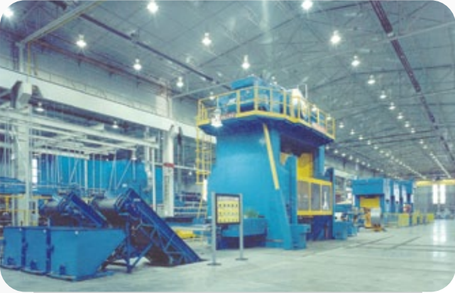
Fabrika Uygulaması: Seri Yakıclı Sistem - Genel Isıtma
