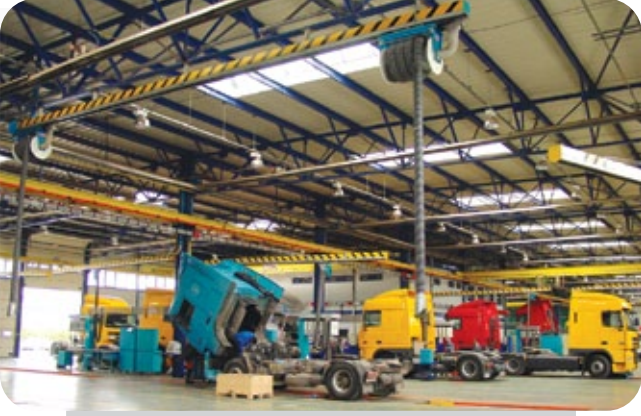
Servis İstasyonu Uygulaması: Seri Yakıclı Sistem - Genel Isıtma
