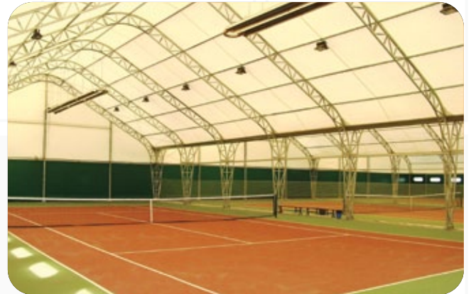
Tenis Kortu Uygulaması: U Tip Üniter Sistem – Genel Isıtma
