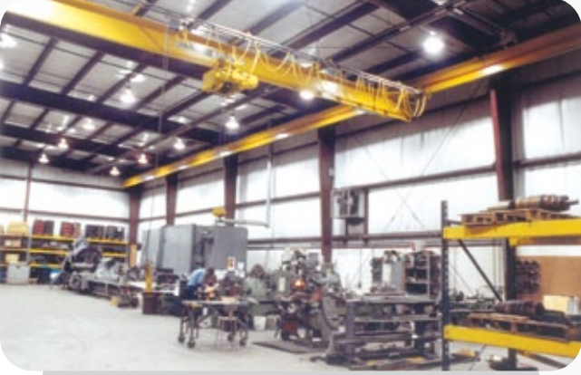
Fabrika Uygulaması: Seri Yakıclı Sistem - Genel Isıtma
