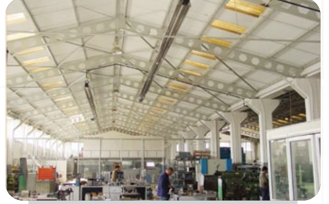
Fabrika Uygulaması: Düz Tip Üniter Sistem – Genel Isıtma
